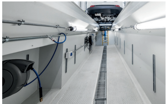
Druckluftversorgung in der Grube
