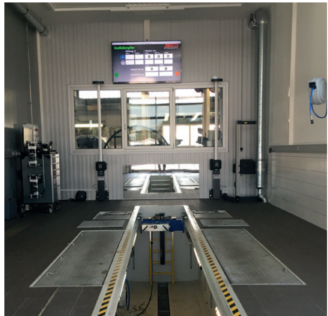
Achsmessgrube mit im Boden integrierten Schiebetafeln
