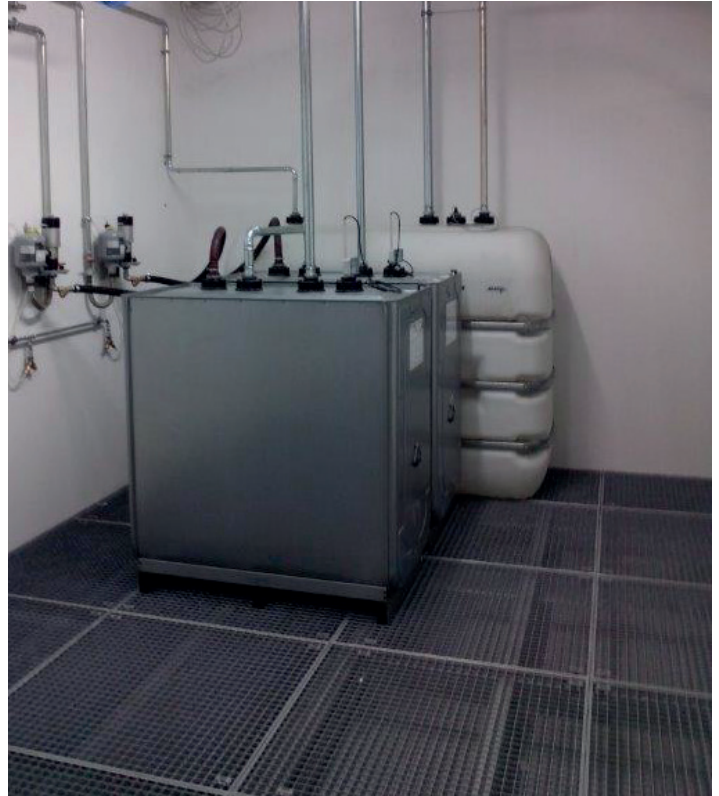
Tankraum mit kompletter Installation.
