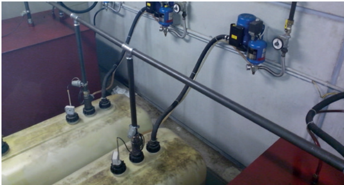
Pumpen und Tankequipment.
