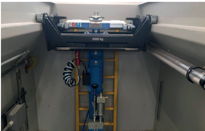
Achsmessgrube mit Slift Grubenheber
