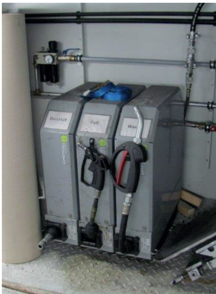
Schlauchaufroller in der Grube.
