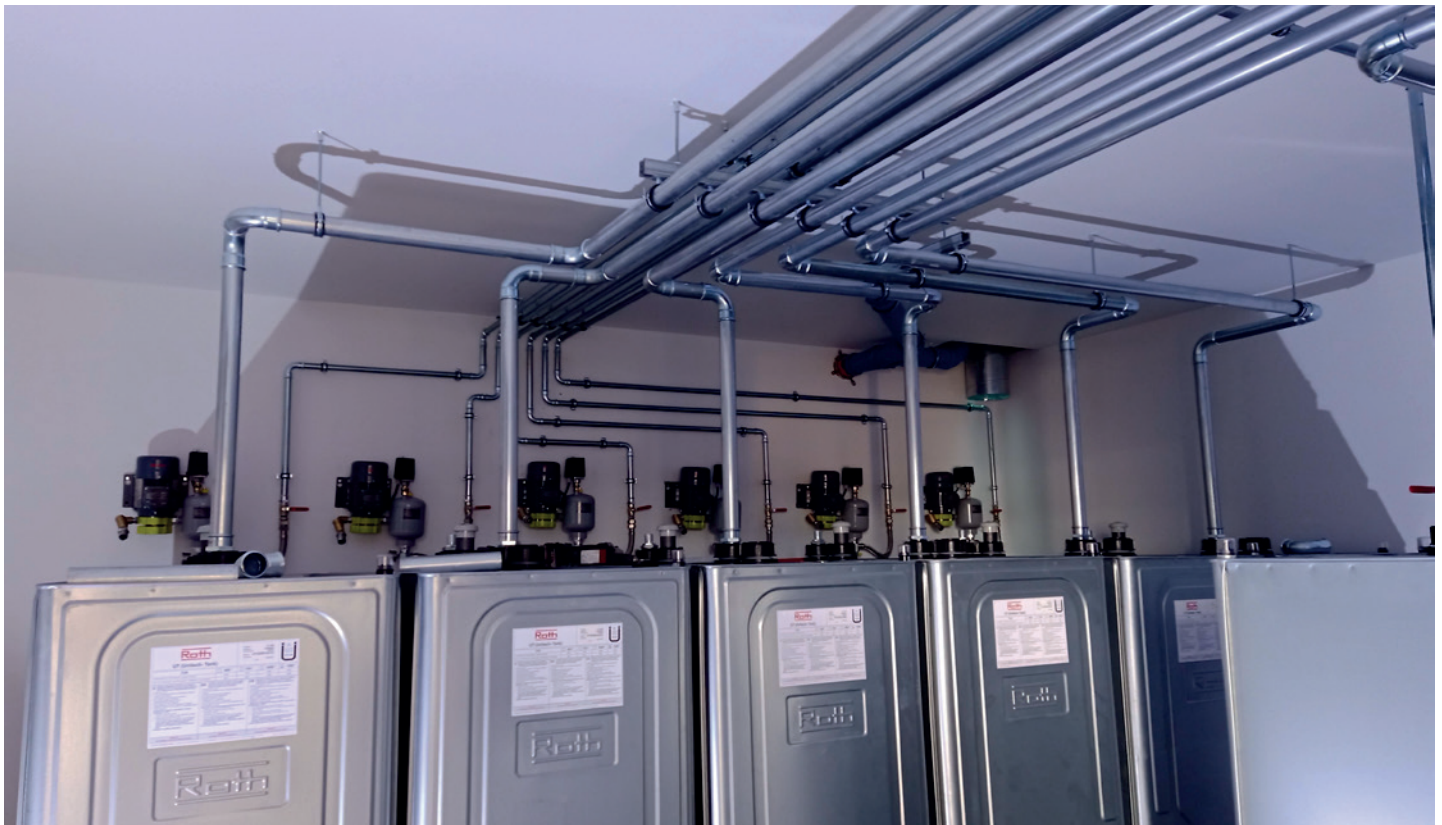
Tankraum mit kompletter Installation.
